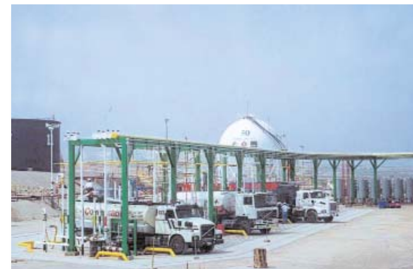
Nuevo Sistema de despacho (top and bottom loading) y Sistema de Aditivación. New dispatch system (top and bottom loading) and additivation system.
