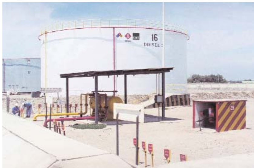
Sistema de espuma contraincendio. / Foam system fighting fire.
