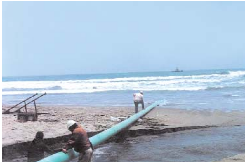
Nuevas líneas submarinas para recepción de productos. / New underwater lines for products reception.
