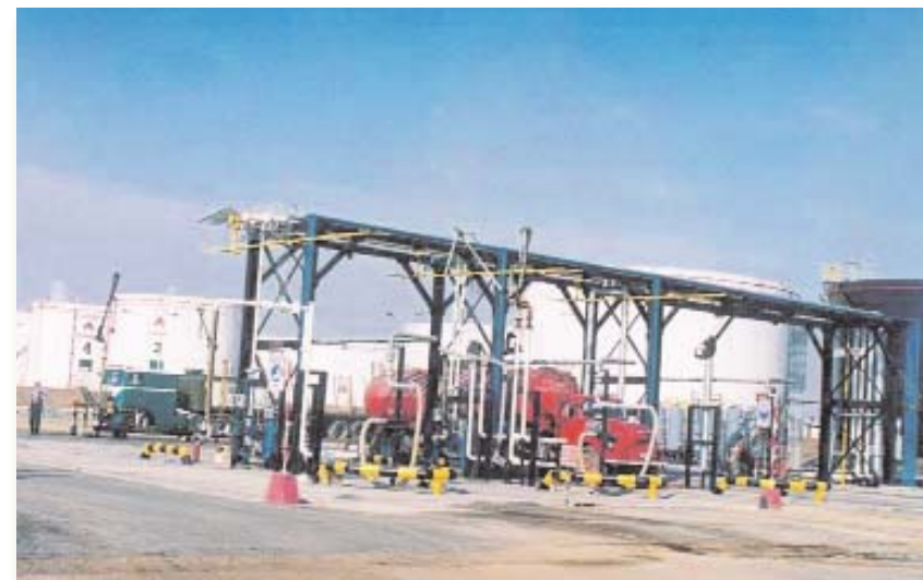
Sistema de despacho y zona de tanques. / Dispatch system and tanks area.
