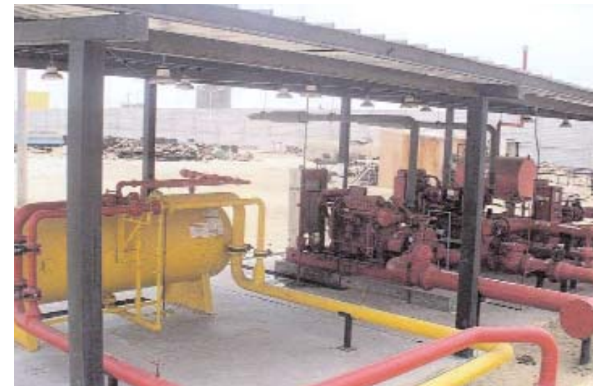
Nuevo equipo contra incendio. Se observan las motobombas de C.I. y el tanque de concentrado de espuma. Fighting fire new equipment. The C.I. Motopumps view and the concentrate foam tank.
