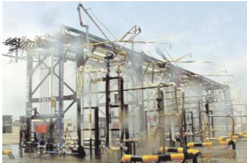
Práctica contraincendio en el sistema de Bottom Loading. / Fighting fire practice at the Bottom Loading System.
